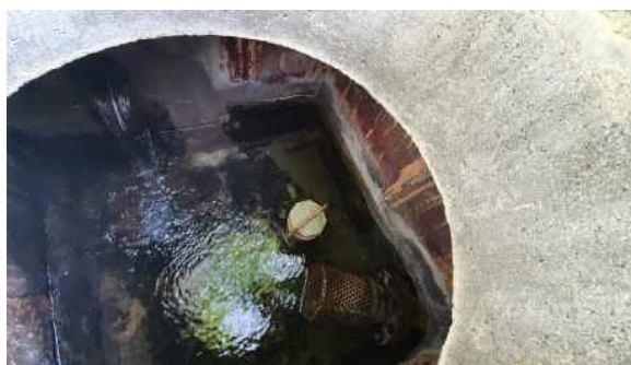
Einlauf und Seiher Abgang zu Reservoir Gambach
