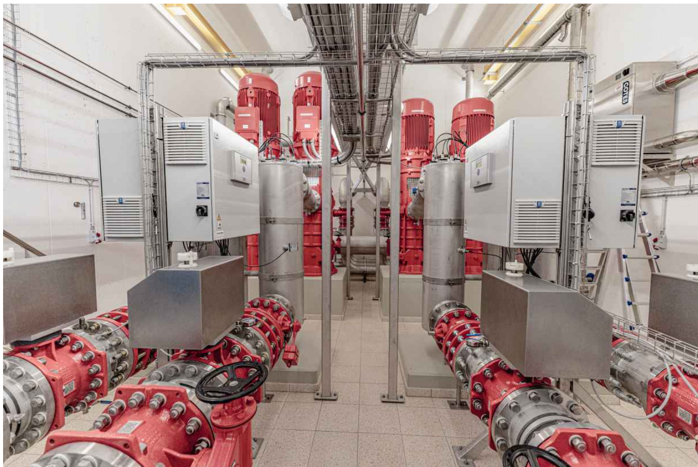
Neues Grundwasserpumpwerk beim Flugplatz Saanen
