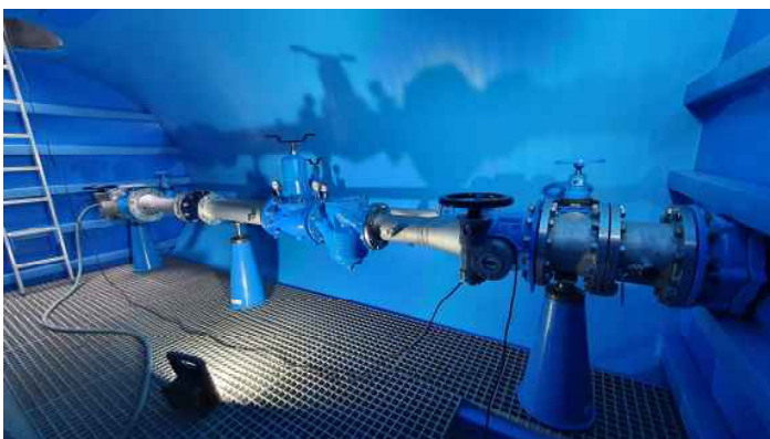
Innen Ausbau aus Chromstahl mit Armaturen Der Firma Hawle und Druckreduzierstation der Firma Erhard
