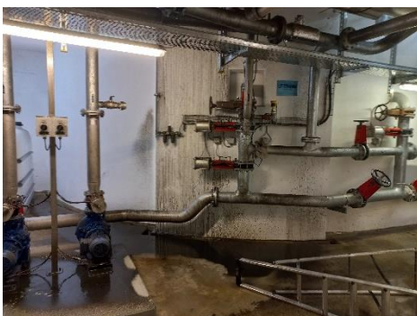
Schlammaustritt in den Keller
