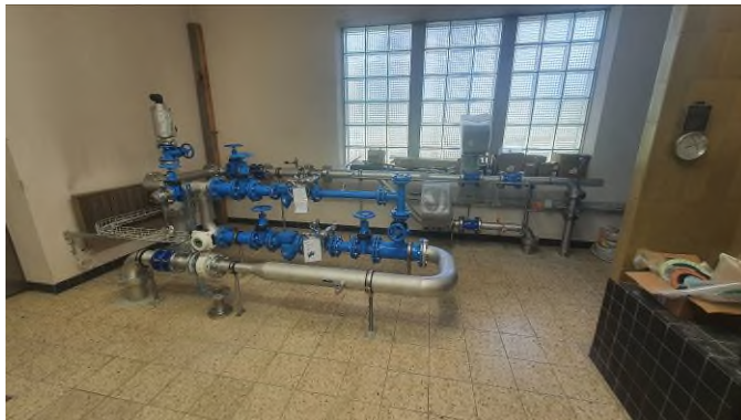
Installation Lauenen im Grundwasser Werk Saanen
